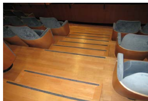
躓き防止安全対策
