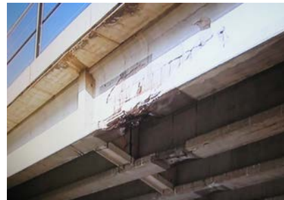
④ 高さ制限違反車両による 橋げたの破損状況
