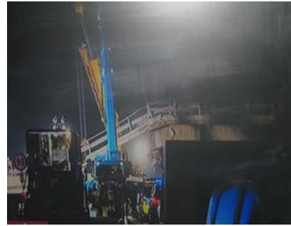
② 跨線橋崩落の事故現場
