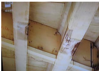
⑤ 事故前の橋げたの破損状況
